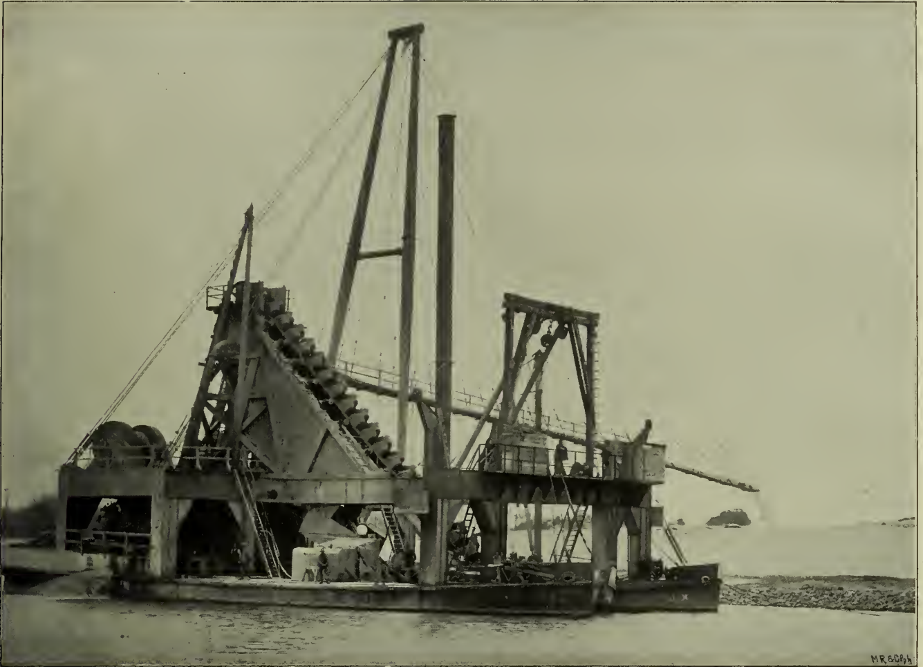
Abbildg. 20. Elevator mit angespültem Sanddamm.
